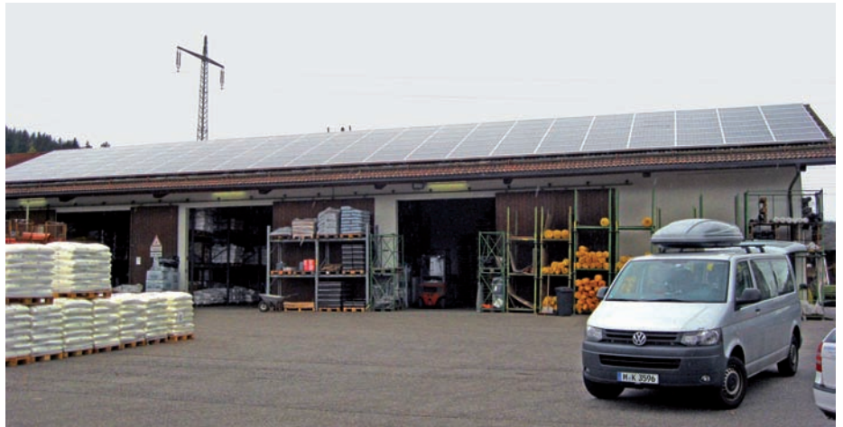
Fotovoltaikanlage VR EnergieGenossenschaft Oberbayern Südost: Das Unternehmen hat bereits mehr als 20 Projekte auf Dächern in der Region realisiert – und es sollen noch mehr werden.
